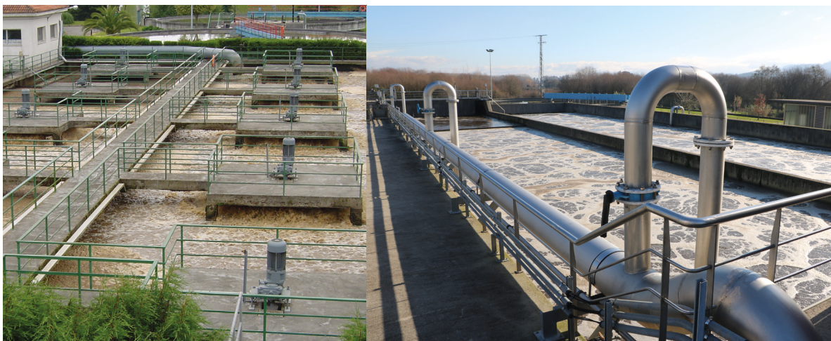
Reactores biolóxicos aerobios (cubas de aireación) das EDAR de Santiago de Compostela (esquerda) e Lugo (dereita).
