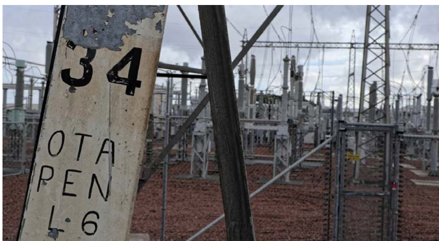
Imagen 13: Transformación de la electricidad generada en una central para su transporte en alta tensión.
