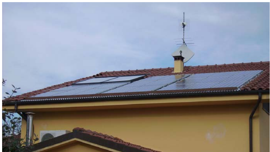
Imagen 99: Fotografía de placas solares instaladas en un techo de una vivienda siguiendo las indicaciones del código técnico de edificación.
