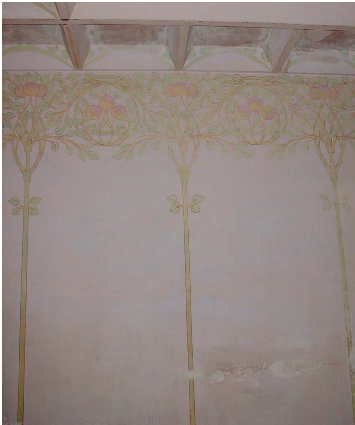
Fig. 6. Pintura mural al temple. Instituto Pere Mata, Reus, habitación del cuerpo central de la segunda planta del Pavelló dels Distingits . Ejemplo del cambio de estilo en parte de las habitaciones de la zona central del edificio, aún sin restaurar, con motivos que abarcan toda la altura de la pared.
