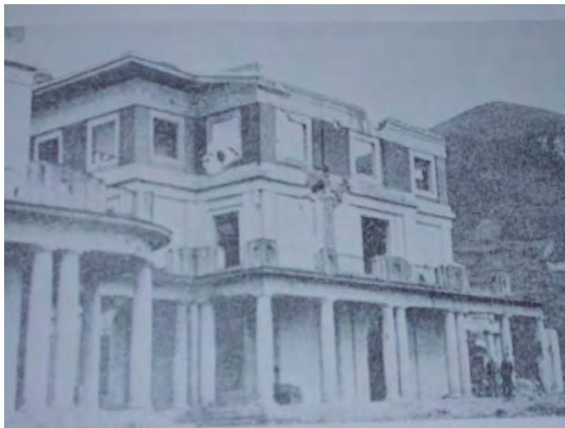
Fig. 5 Pabellón de Administración, Sanatorio del Naranco, Oviedo. Parcialmente destruido tras la Guerra Civil
