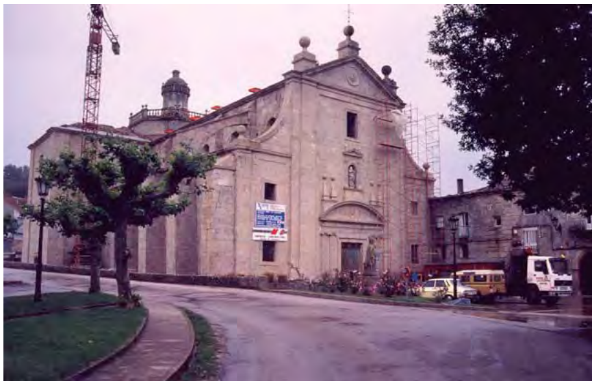
Fig. nº. 4.- Monasterio de Montederramo. Vista general rehabilitado. Fuente.- Archivo del IRCBCC.
