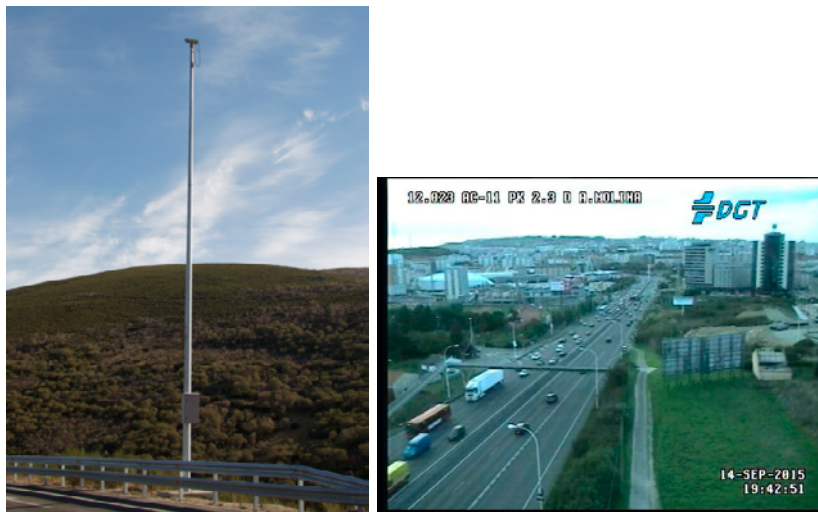
Figura 2.3 Sistema de CCTV
