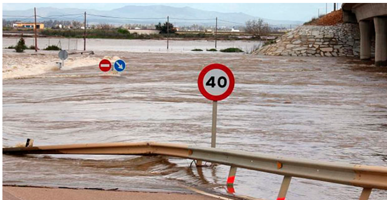
Figura 4.2: Inundación de estrada
